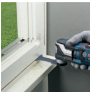
Tauchschnitt in Holz oder Metall, z. B. für Ausbau Fensterrahmen oder Ausbau Türzarge
